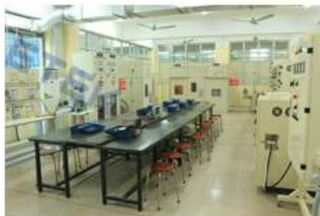
Hệ thống đào tạo vận hành, bảo vệ và truyền tải điện năng
